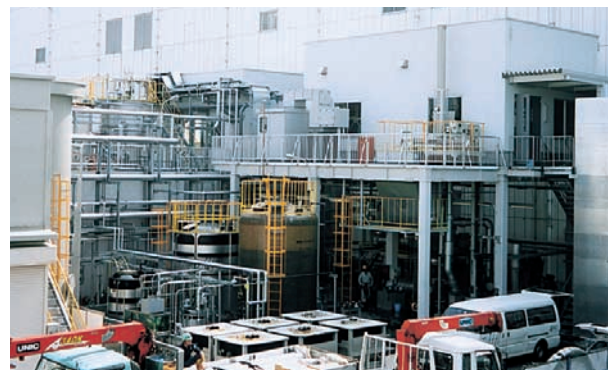
新染色排水処理設備
